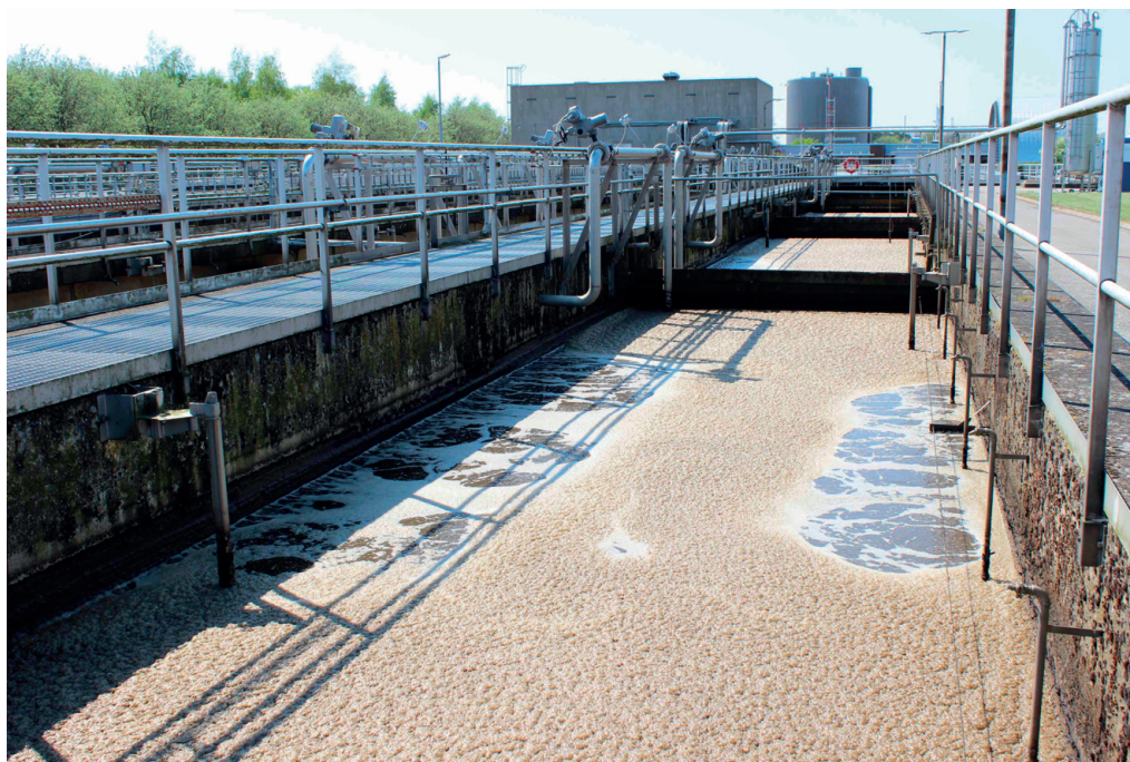
Figur 3.3: Aktivslamprocessen vid Klagshamns ARV. Foto: Christoffer Wärf.
