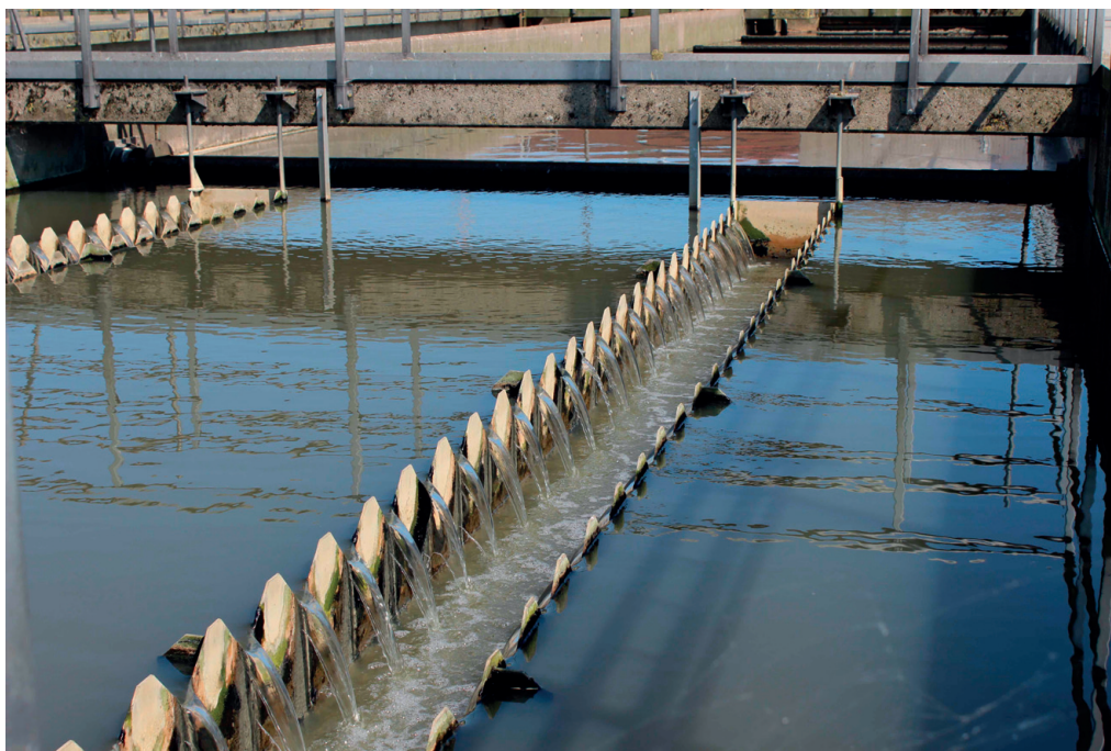
Figur 3.2: Försedimentation vid Klagshamns ARV. Foto: Christoffer Wärrff.
