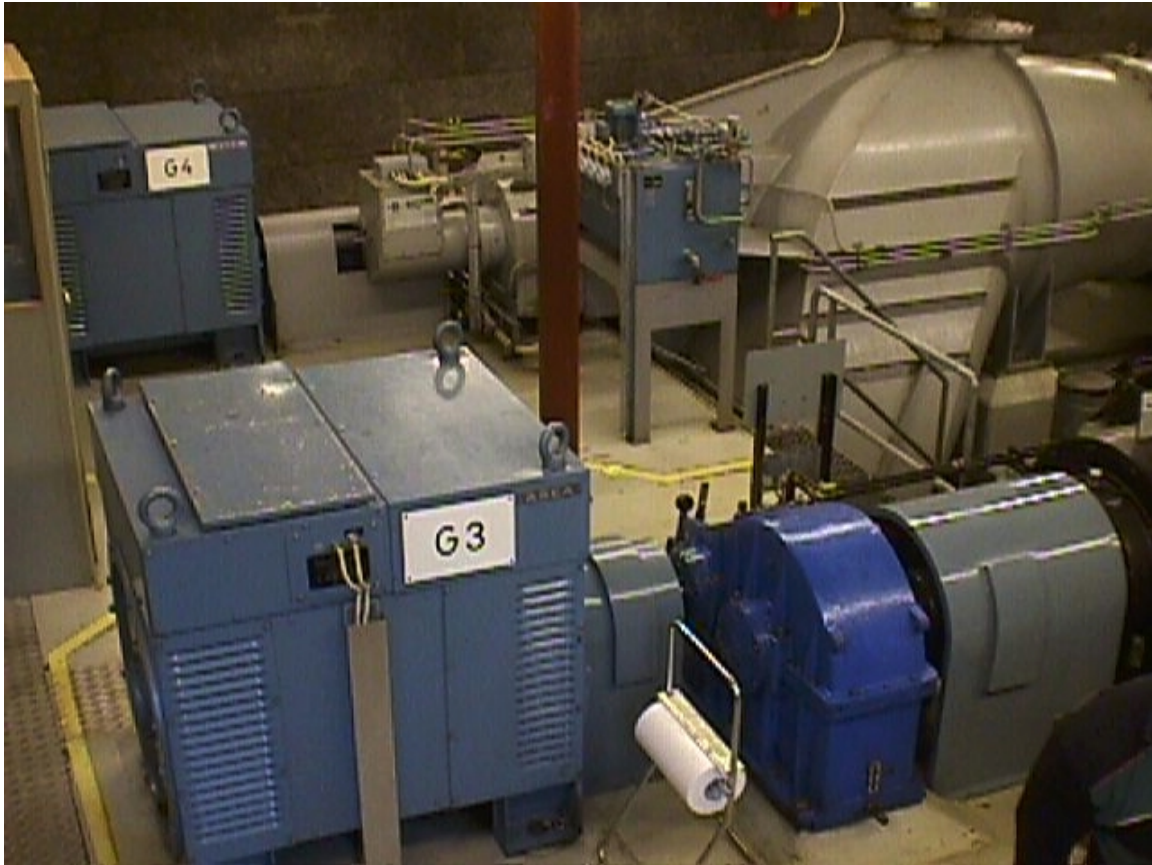
Figur 1.4 Foto från maskinhallen i KLE K2. I förgrunden till höger syns växellådan till aggregat 3 och till vänster generator 3. I bakgrunden till höger syns turbinen till aggregat 4. Mitt i bilden syns den hydrauliska utrustningen som ställer in turbinens löphjul för olika pådrag.
